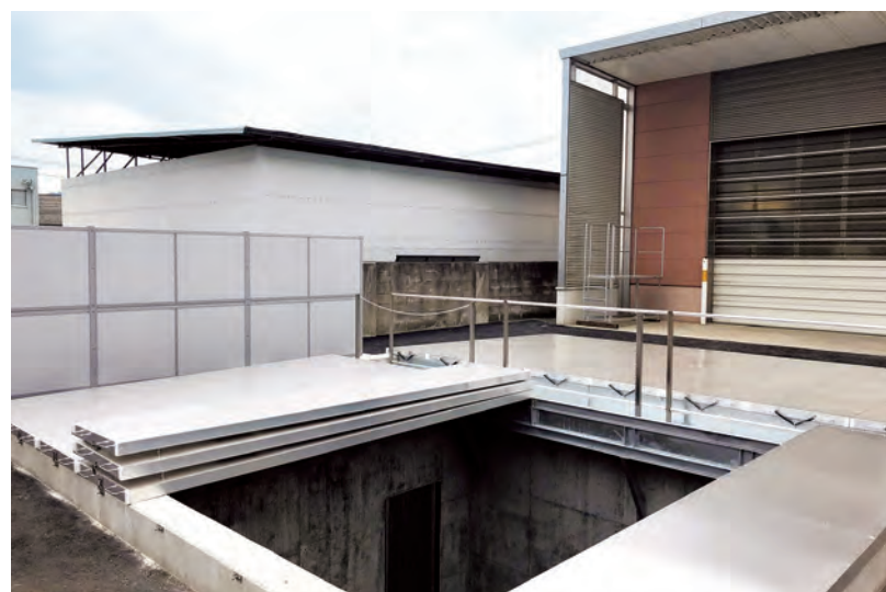
汚泥脱水施設（固定式）の概要 処理能力：5.55㎡/時間 133.2㎡/日 24時間稼働
