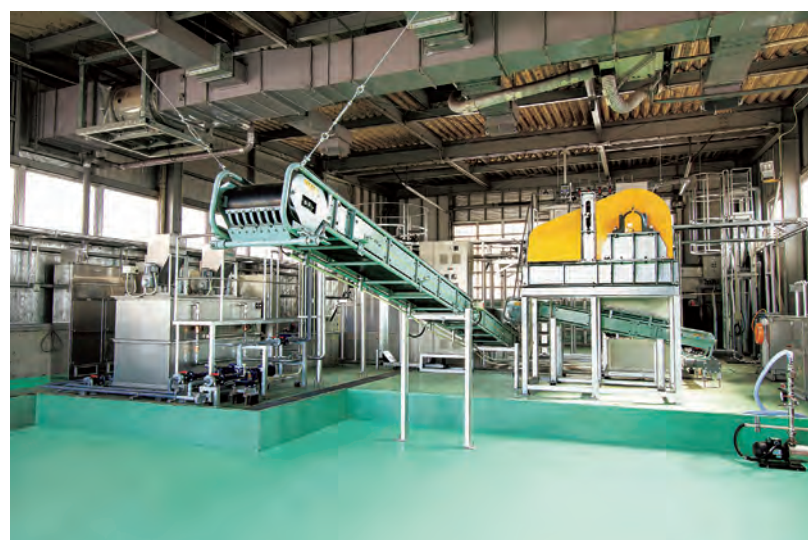
▲ 併設の汚泥槽
