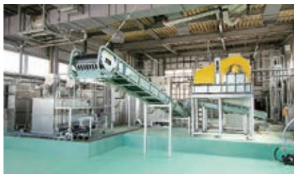
脱水施設の概要 ●処理能力 133.2m 3 /日 ●処理品目 汚泥全般
